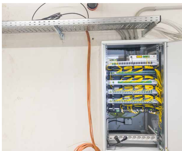
Abbildung 48: Gebäudeverteiler mit Kabelführungssystem
