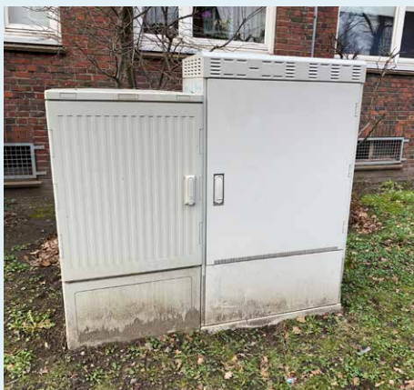
Abbildung 31: zentraler Infrastrukturpunkt Außenschrank (Außenansicht)
