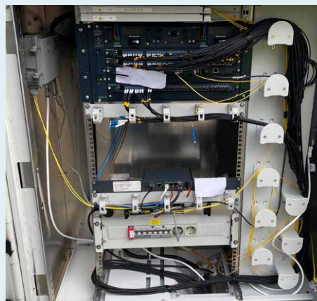
Abbildung 32: zentraler Infrastrukturpunkt Außenschrank (Innenansicht)
