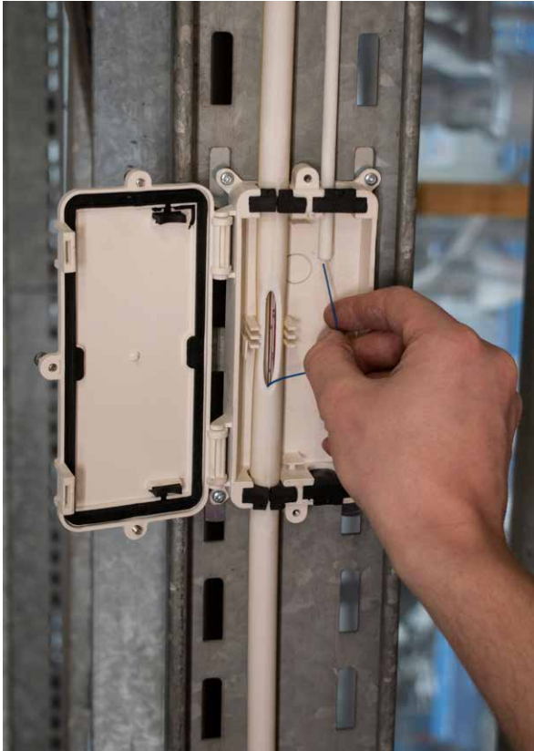
Abbildung 62: Ausleitung von Glasfaserkabeln aus einer Steigleitung heraus
