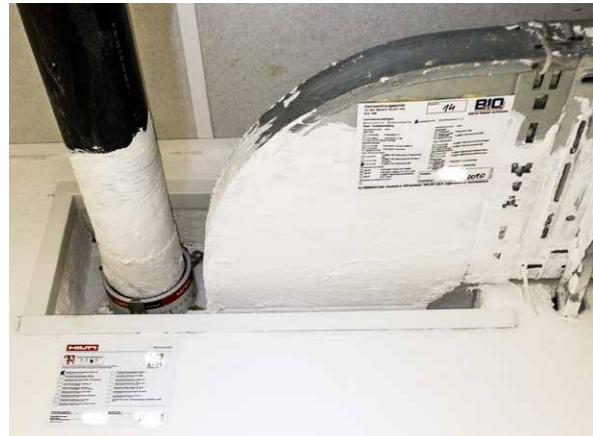
Abbildung 64: Brandschottung für eine Kabelwanne und ein Abflussrohr
