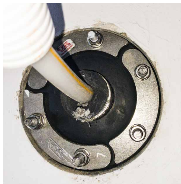
Abbildung 23: Einspartenhouseinführung für einen Netzbetreiber
